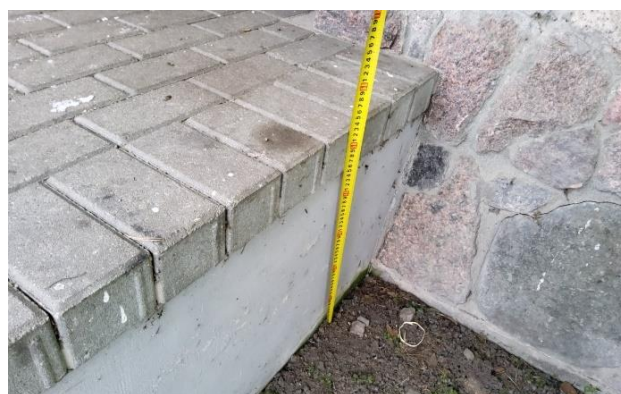
4.10.6.att. Augstuma starpība starp kāpņu laukumu un zemes virsmu ir 52 cm
