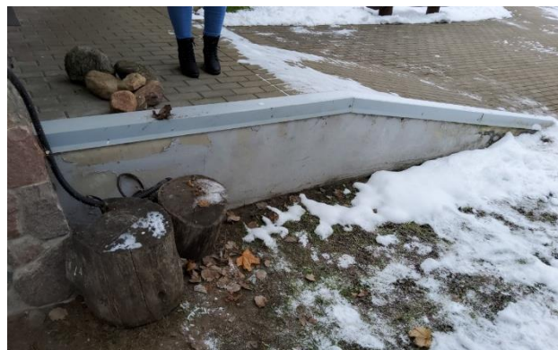
4.19.4.att. Ārējo kāpņu dekoratīvās apdares bojājumi
