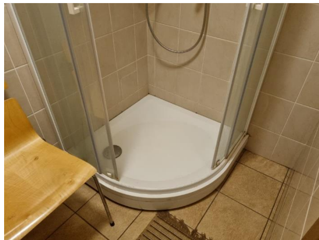
5.1.6.att. Uzstādītā duškabīne
