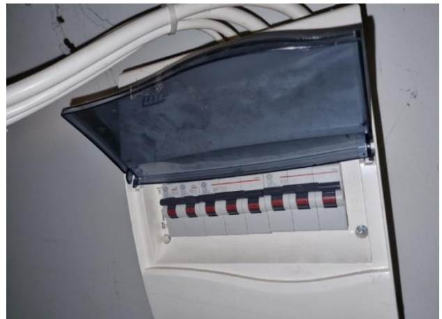
5.9.2.att. Siltumsūkņa elektrosadalne
