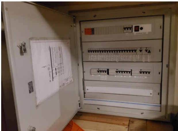
5.9.1.att. Ēkas galvenā elektrosadalne
