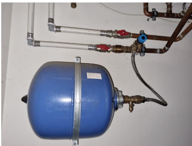
5.2.1.att. Karstā ūdens caurules un izplešanās tvertne
