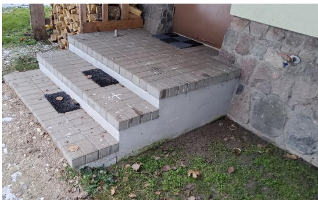
4.19.3.att. Ārējo kāpņu dekoratīvās apdares bojājumi
