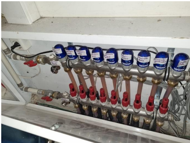
5.4.3.att. Apsildes sistēmas kolektoru skapis
