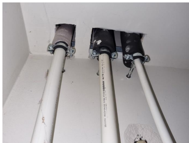
5.2.2.att. Karstā ūdens cauruļu siltuizolācija
