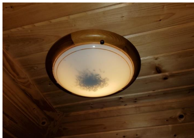
5.9.6.att. Gaismekļa iekšpusē iekļuvušas mušas
