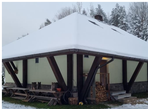
5.6.4.att. Ārsienā izbūvētās gaisa ieņemšanas un izmešanas restes
