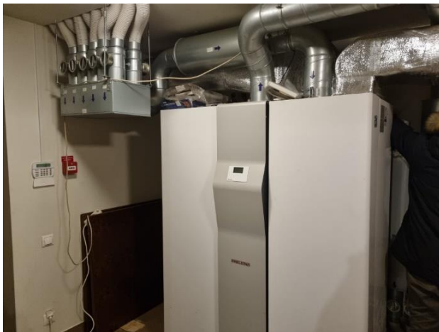
5.4.1.att. Kombinēta tipa siltumsūknis Stiebel Eltron LWZ 304/404 SOL
