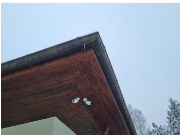
4.8.7.att. Izveidojusies lāstekas lietusūdens teknes posmu savienojuma vietā
