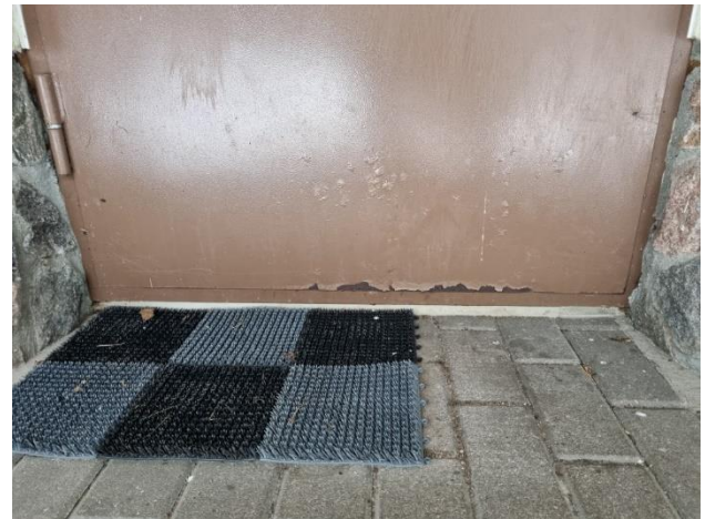
4.13.4.att. Tehniskās telpas ārējo durvju apakšējā daļā radušies korozijas bojājumi
