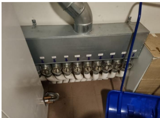
5.6.3.att. Pieplūdes gaisa kolektors
